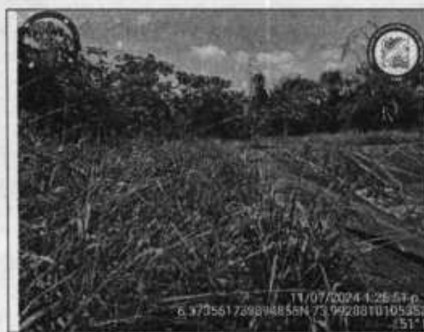
Fotografía 12. Obstrucción de los canales perimetrales de la celda 4, actualmente operativa.
