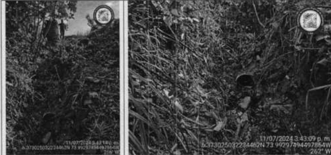
Fotografía 16, 17: Punto de descarga de lixiviado sobre una zanja y/o cuneta construida sobre el suelo desnudo, referenciado bajo las coordenadas geográficas Lat: 6.373025, Long: -73.992975.
