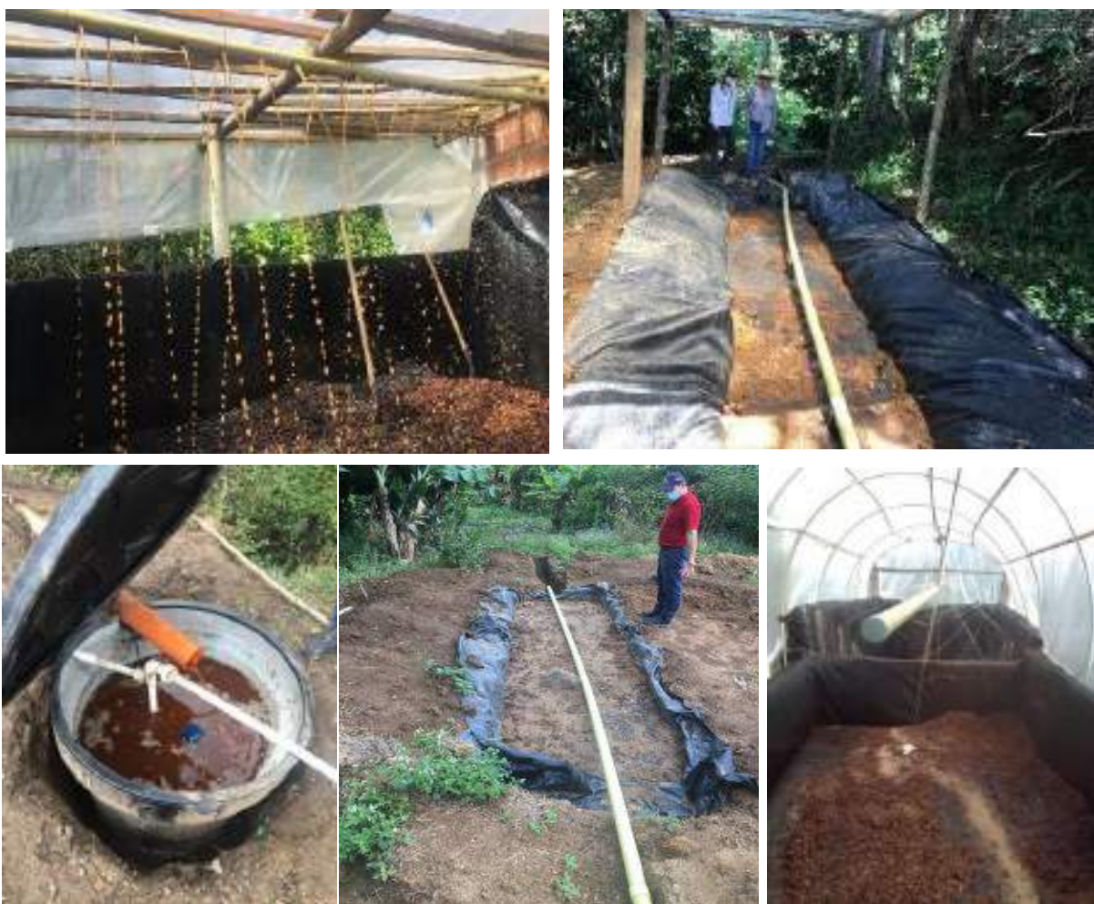
Figura 7. Instalación de sistemas para mitigar el impacto de las aguas residuales del beneficio de café
