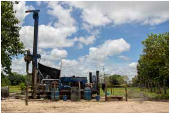
Perforación Pozo en la comunidad Dachi Drua - vereda Campo Capote, municipio de Puerto Parra
