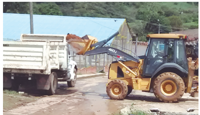
Atención de emergencia por deslizamientos.
