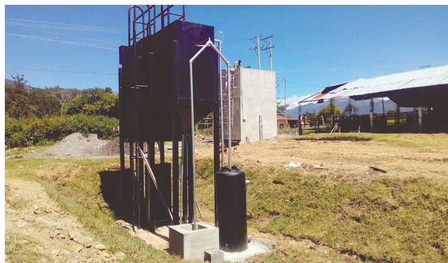
Planta de Tratamiento de aguas residuales municipio de Málaga.
