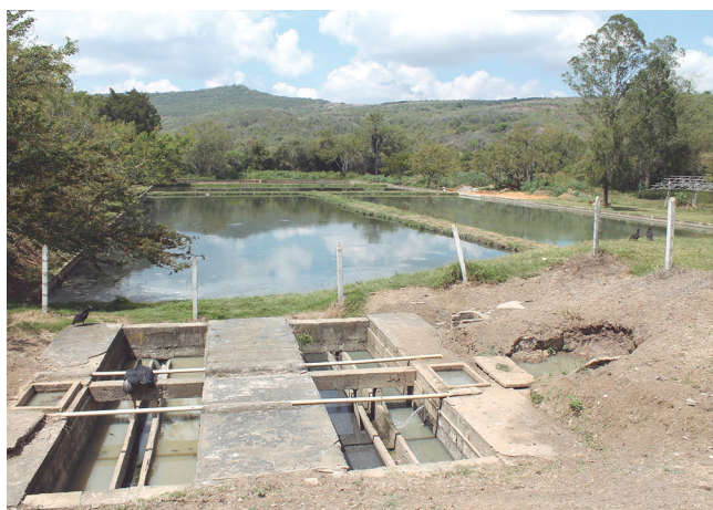
PTAR actual Municipio de Curití
