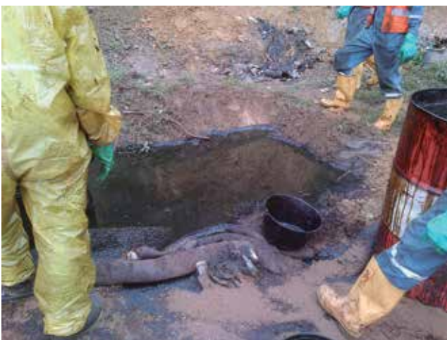
Seguimiento a 54 derrames de hidrocarburos en la jurisdicción de la C.A.S.
