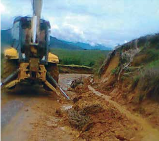
Municipio de Confines: Apoyo de la retroexcavadora, por emergencias ambientales en la zona rural del municipio.
